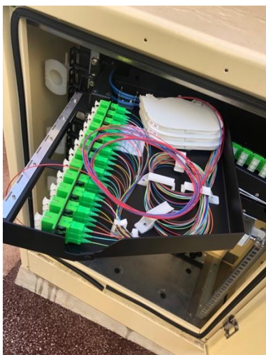
Cette photo représente une tête avec trois cassettes, chacune des cassettes sont composées de 12 clients. Cela veut dire que dans une cassette, nous pouvons faire passer deux tubes de fibre. Donc, en tout, nous pouvons faire passer six fibres indépendantes. En tout sur l'exemple, la tête est composée de 36 clients.
